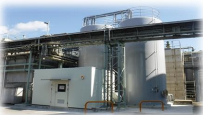
食品加工場排水処理施設 (平成27年10月納入・兵庫県)
