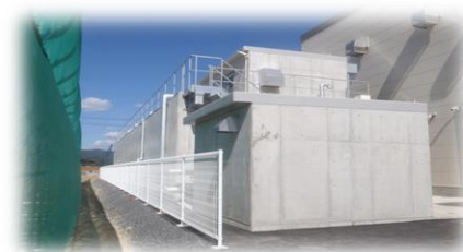
食品加工場排水処理施設 (平成25年5月納入・宮城県)
