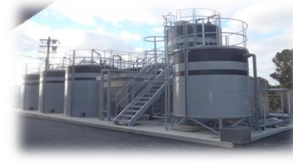
食品加工場排水処理施設 (平成27年1月納入・三重県)
