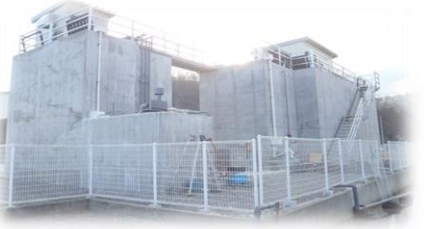
水産加工場排水処理施設 (平成27年9月納入・宮城県)
